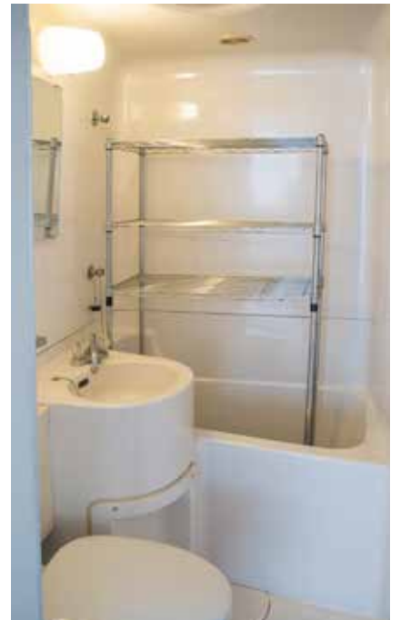
建築当初はユニットバスになっていたの現状はバスを廃止し、収納用のスチール棚を組み込んでいます。
